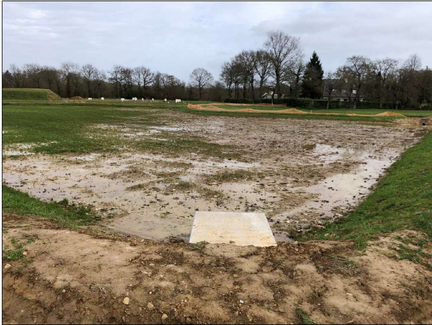
Photo 11: Au premier plan, le dalot d'entrée et l'ouvrage de gestion des eaux pluviales du bassin-versant A et, au second plan, à gauche l'ouvrage de régulation et la zone humide balisée
