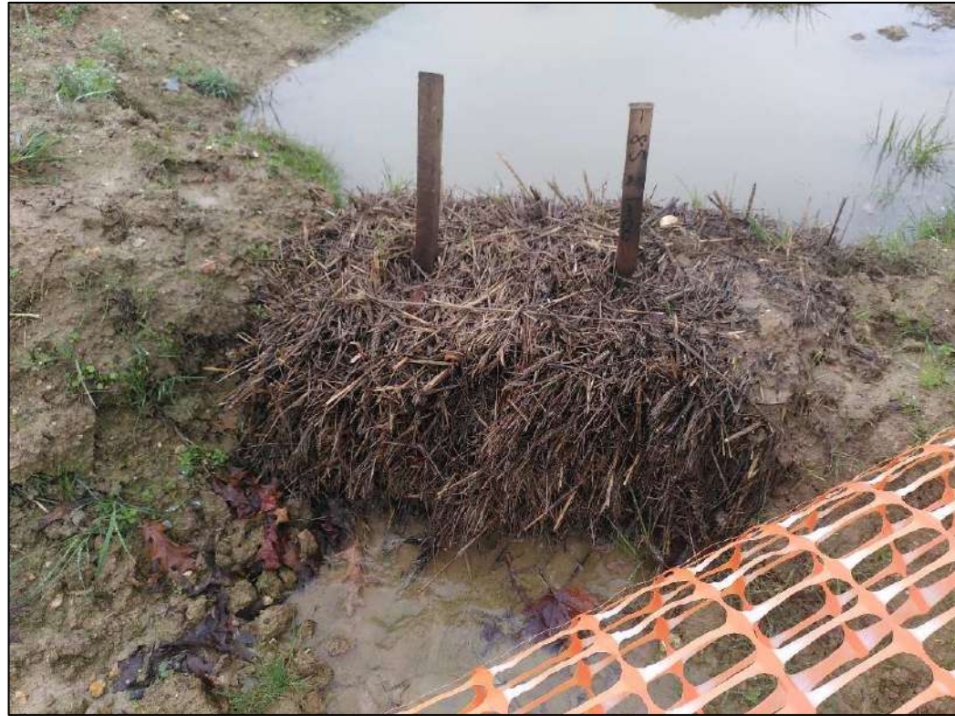
Photo 9: dispositif de filtration en sortie de bassin de gestion des eaux pluviales du bassin-versant A, en phase chantier
