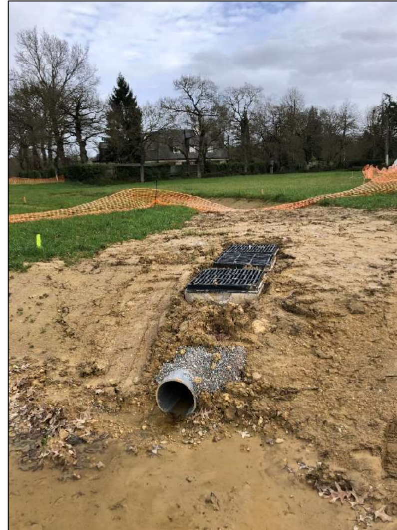
Photo 10: ouvrage de régulation du bassin de gestion des eaux pluviales du bassin-versant A
